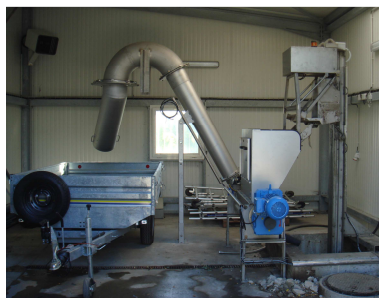
Nouvelles installations électriques (2013)
